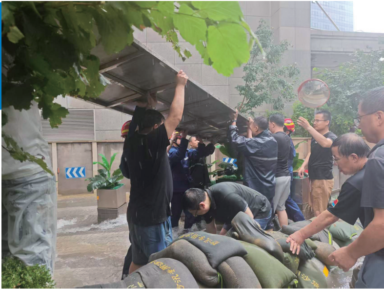
7月13日,财富中心A座因积水迅猛冲垮地下出入口挡水挡板,雨水持续向内倒灌,沈阳市金融商贸开发区消防救援大队第一时间赶赴现场,重新封堵进水点位,有效阻断积水倒灌,快速处置防汛险情,保障楼宇财产与群众出行安全。
