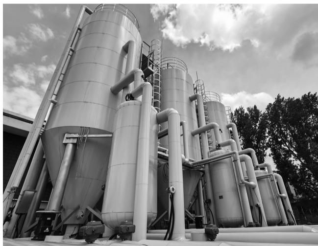
东北地区净水厂首个浓缩罐+低温负压板框压滤机污泥处理场景正式落地沈阳。 水务集团供图
