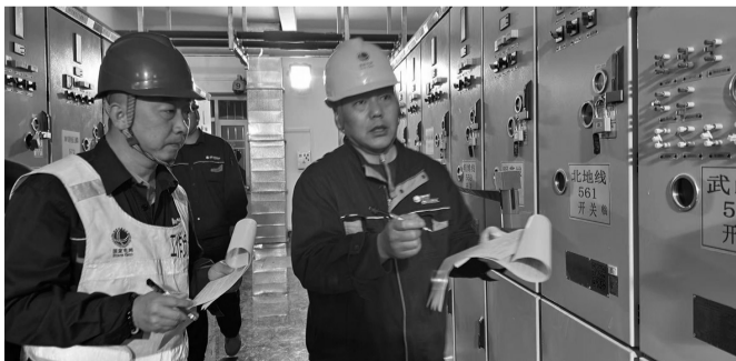
此次春检彻底消除了明山变设备安全隐患。 受访者供图
