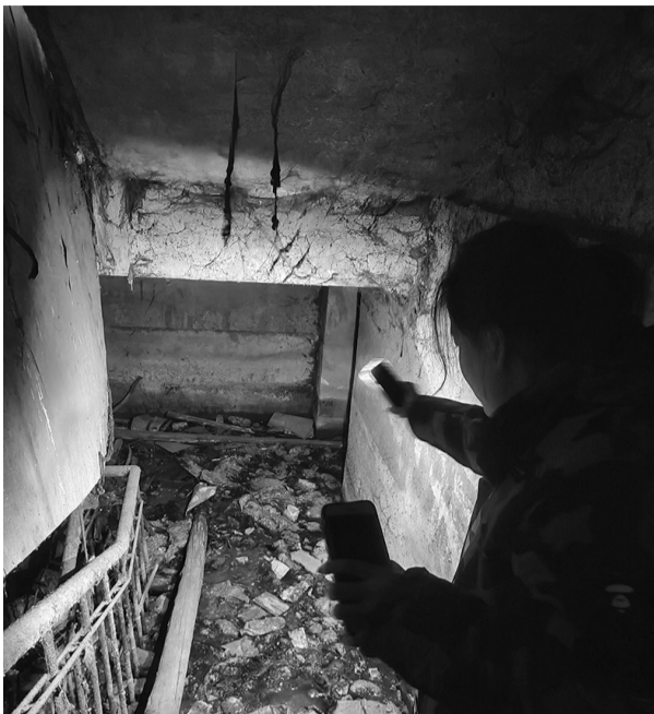
4月14日上午,记者跟随方女士来到该居民楼地下室。手电光下,浑浊的污水已淹没楼梯台阶。
