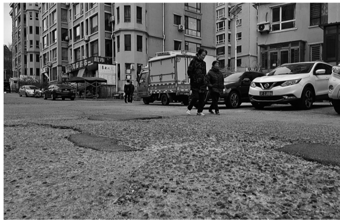
丹东市益荣佳园小区内的路面残破不堪。本报记者 吴章杰 摄
