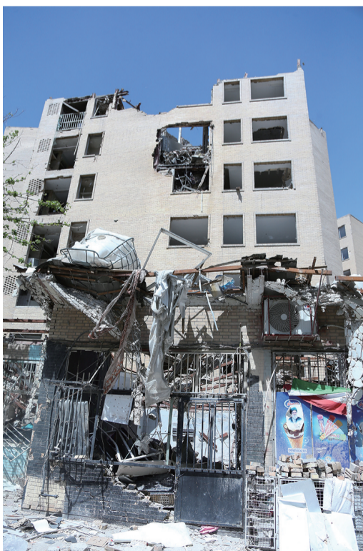
这是4月14日在伊朗首都德黑兰东南部一处居民区拍摄的遭美以袭击严重受损的楼房。 新华社记者 沙达提 摄
