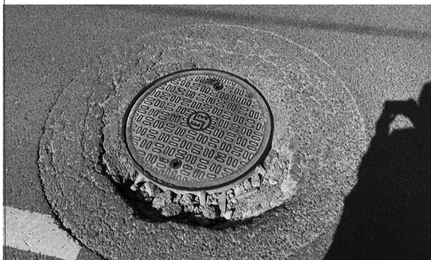
事发时，井盖周边下陷，路面破损。 受访者供图
