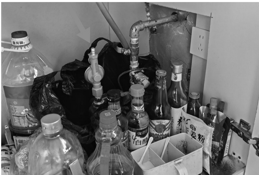
燃气管网已经铺设到居民家的厨房,但是没有开栓。
