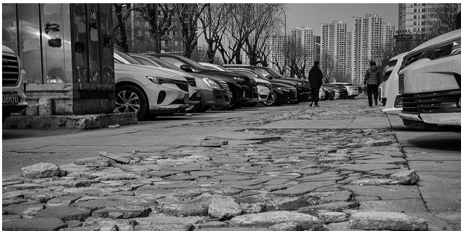
融城时代小区外的辅路地砖破损严重。
