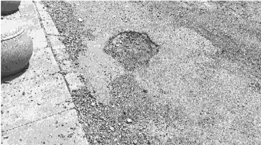
葫芦岛市文兴南路辅路破损严重。
