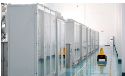
国网大连供电公司智能轮式机器人正沿着港东220千伏变电站主设备间预设巡视线路,进行设备红外测温。 聂鑫 摄
