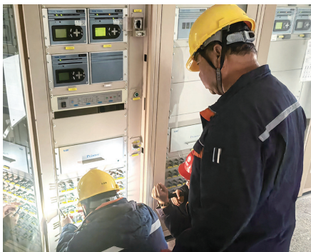
运维人员进行送电操作。 受访者供图
