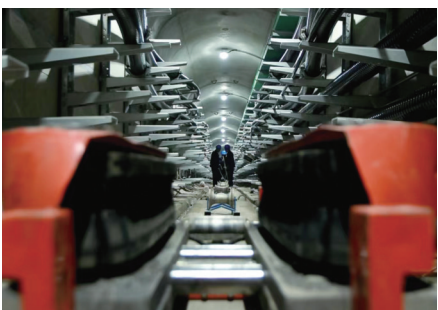
在深邃的电缆管廊内,工作人员正在加紧敷设电缆。 受访者供图
