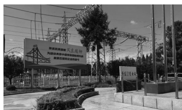
丹东220千伏变电站。 资料图
