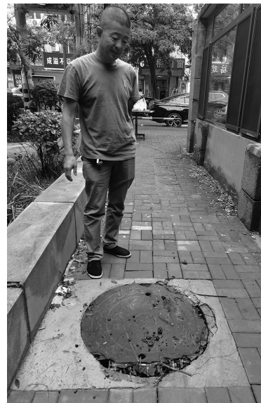
井盖已经破损,很危险。 辽沈晚报记者 金国建 摄
