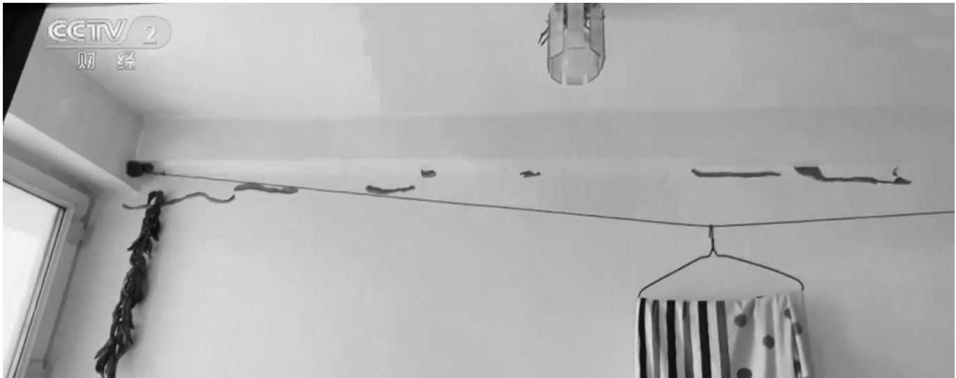
该楼内一居民家中墙壁出现裂缝。
