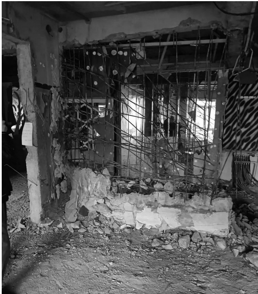
涉事楼层装修时砸掉的墙体。
