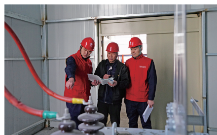
11月16日,国网本溪供电公司客户服务经理为本钢集团有限公司的用电设备进行检查。国网本溪供电公司供图
