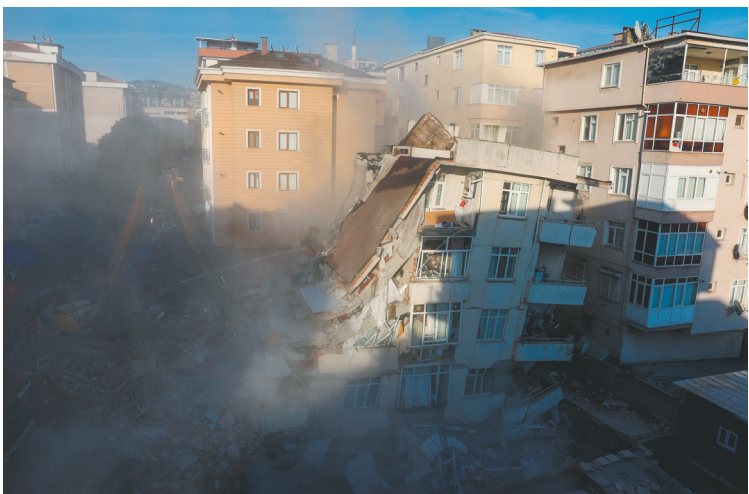
土耳其伊斯坦布尔一栋7层建筑8日部分坍塌,造成5人死亡。图为在伊斯坦布尔拍摄的坍塌建筑。本版稿件和图片均据新华社电
