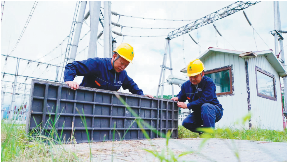
国网本溪供电公司员工在桓仁220千伏变电站开展防汛隐患专项排查,防止积水威胁电力设备安全。 张雪圆 摄
