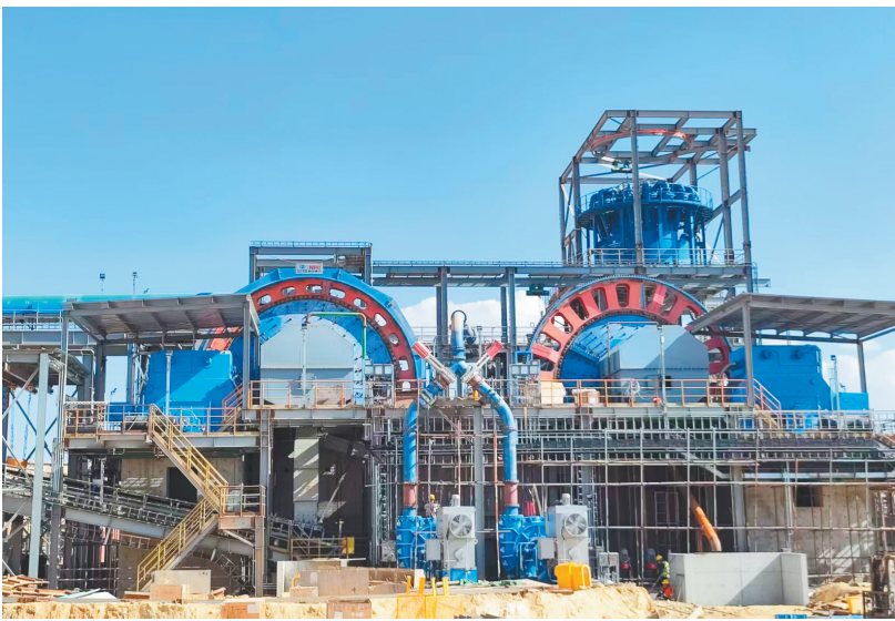
今年4月，厄立特里亚阿斯马拉多金属矿项目顺利产出首批精矿，北方重工研制的核心选矿装备展现中国装备实力。 杨贺 摄
