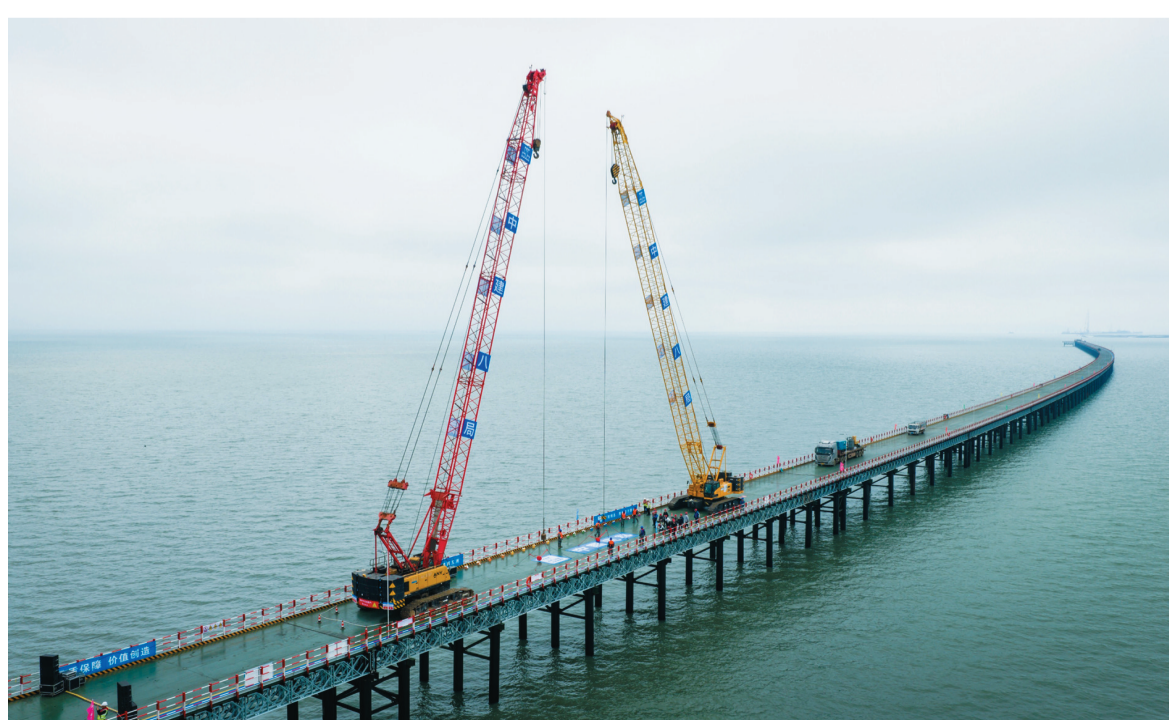
图为大连长海大桥主线钢栈桥首段合龙施工现场。赵海权 摄
