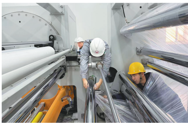
奥克集团无色透明聚酰胺全产业链项目施工现场,工作人员正在对设备进行调试。 本报见习记者 胡潇文 摄
