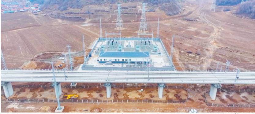
国网抚顺供电公司 对沈佳高铁沈白段牵引站一次成功送电。 刘岳龙 摄
