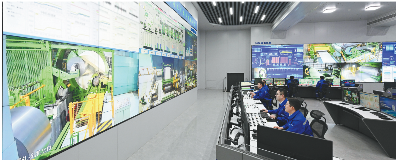
本钢板材冷轧总厂第三冷轧厂集控中心。
