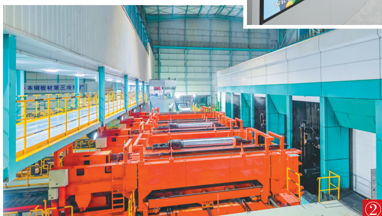
①本钢板材冷轧总厂第三冷轧厂集控中心内景。
