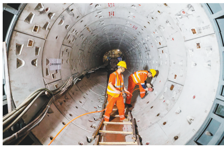
1月16日,施工人员在广州海珠湾隧道6号联络通道内紧固隧道管片螺栓。当日,由中铁十四局承建的广州海珠湾隧道东西线之间6座承担人员疏散、消防等功能的联络通道全部贯通,这也是国内首个采用小盾构法施工的超大直径水下盾构隧道联络通道。
