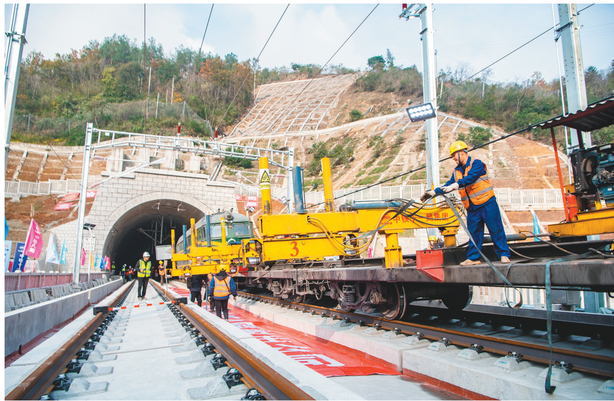
12月15日拍摄的渝厦高铁重庆东至黔江段武隆区白马山隧道出口施工现场。当日,在渝厦高铁重庆东至黔江段武隆区白马山隧道出口施工现场,随着中铁十一局建设者将最后一对500米长钢轨顺利铺设到接轨点,渝厦高铁重庆东至黔江段全线铺轨完成。渝厦高铁重庆段是国家中长期铁路网规划“八纵八横”中渝厦通道的重要组成部分,从重庆站引出,途经重庆东、巴南、水江西等站,止于重庆市黔江区,正线全长269.5公里,设计时速350公里。建成通车后,将大大缩短重庆主城区至黔江区的列车旅行时间。新华社记者 唐奕 摄
