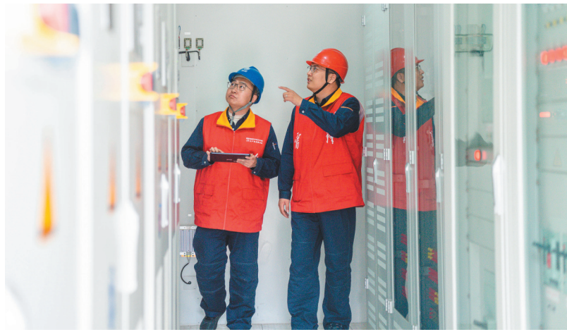
国网大连供电公司员工在柔性直流配网系统设备间开展巡检工作。 关云达 摄
