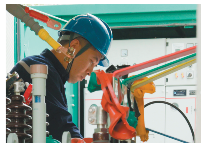
国网营口供电公司员工在恒大绿洲小区地下配电室迁改施工现场进行变压器试验操作。于兴润 摄
