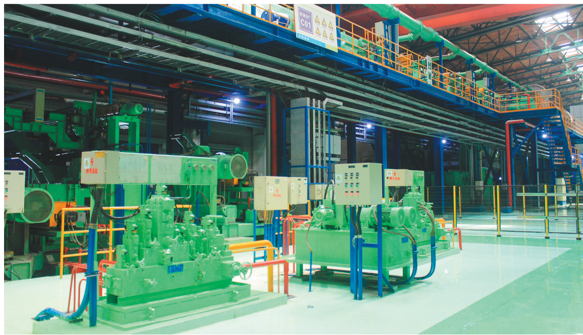
鞍钢冷轧厂涂镀分厂彩涂工区的生产车间里生产设备高速运转。
