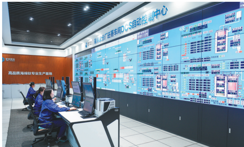
金钛股份海绵钛分厂还蒸车间DCS自动控制中心。
