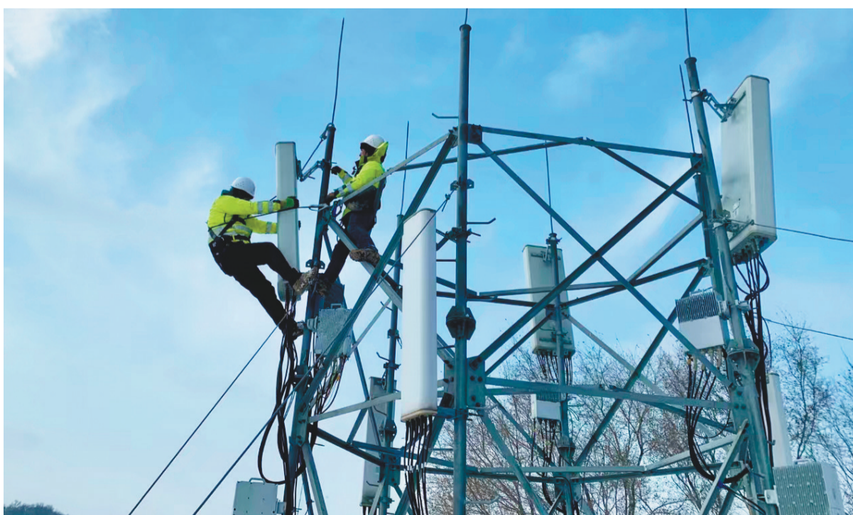
中国移动辽宁公司技术人员对基站设备进行维护。
