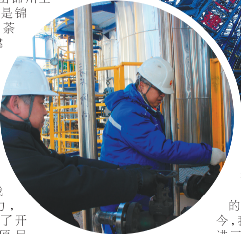
锦州石化公司40万吨/年针状焦项目现场,核心设备焦炭塔正在吊装。
