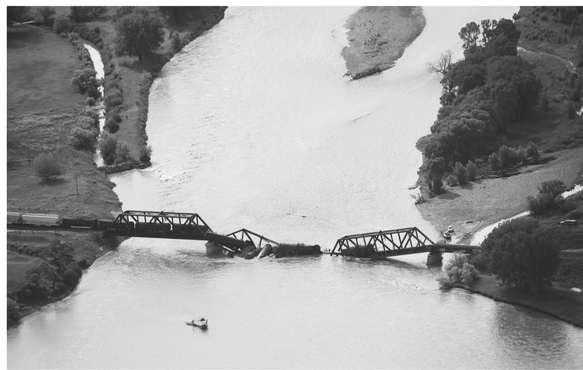
这是6月24日在美国蒙大拿州哥伦布附近拍摄的倒塌的桥梁和坠入黄石河中的火车。据外媒报道,一列货运火车当日在经过黄石河上的桥梁时遭遇桥梁倒塌并坠入河中。
