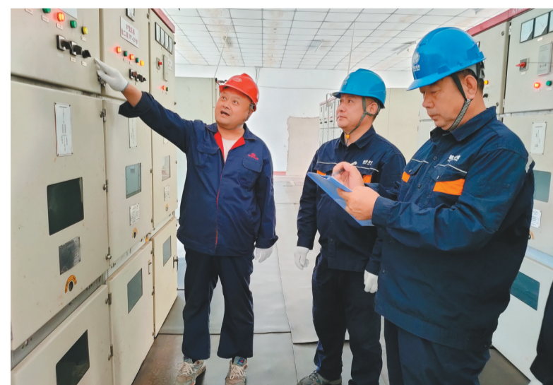
日前,国网辽宁朝阳供电公司开展用电“送服务保安全、解难题促发展”活动,组织专业人员对企业客户用电设备进行安全“体检”,现场解答企业用电问题,持续优化营商环境,服务企业健康发展。图为国网辽宁朝阳供电公司工作人员在朝阳百盛铝业股份有限公司现场解决企业用电难题。 郭娜 摄
