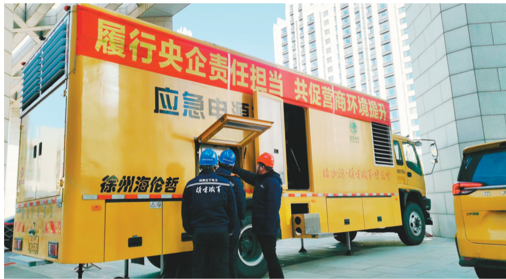
国网葫芦岛供电公司派出应急电源车,为葫芦岛市2022年“项目为王”和营商环境建设总结表彰暨2023年动员部署大会提供供电服务。吴冬 摄
