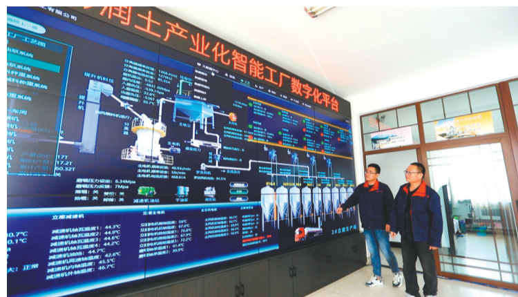
辽宁地恩瑞科技有限公司中控室技术人员通过PLC电脑和数字大屏幕实时监控生产设备运转、产品质量和罐区装车等信息。
