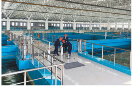
水净化处理现场。
