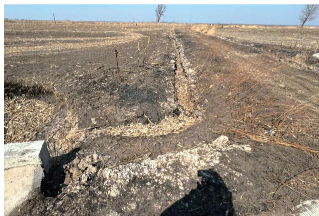
整改前，涵洞未对齐水渠，水流冲毁农田无法耕种。
