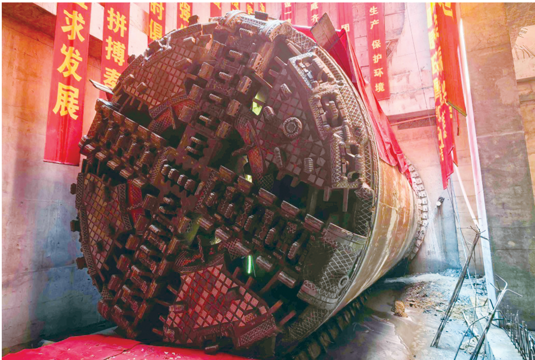
在沈阳地铁6号线三好桥站，一台泥水平衡盾构机刚刚完成下穿浑河任务，精准到达指定接收位置。
