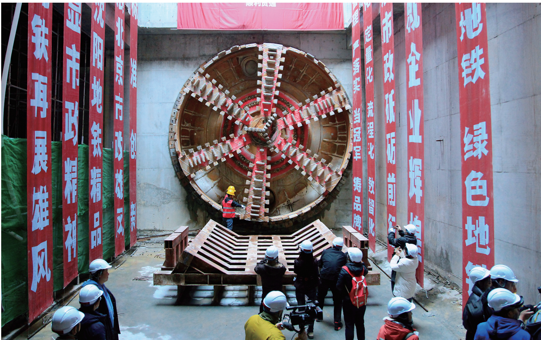
3月26日,沈阳地铁6号线市图书馆站—沈水路站区间右线顺利贯通,这是地铁6号线首个单线贯通的区间。
