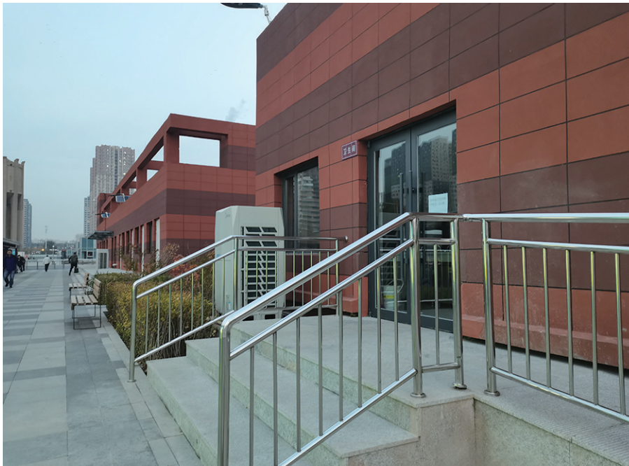
沈阳站西广场公交枢纽站卫生间已经投入使用,但标识牌较小不易识别。
