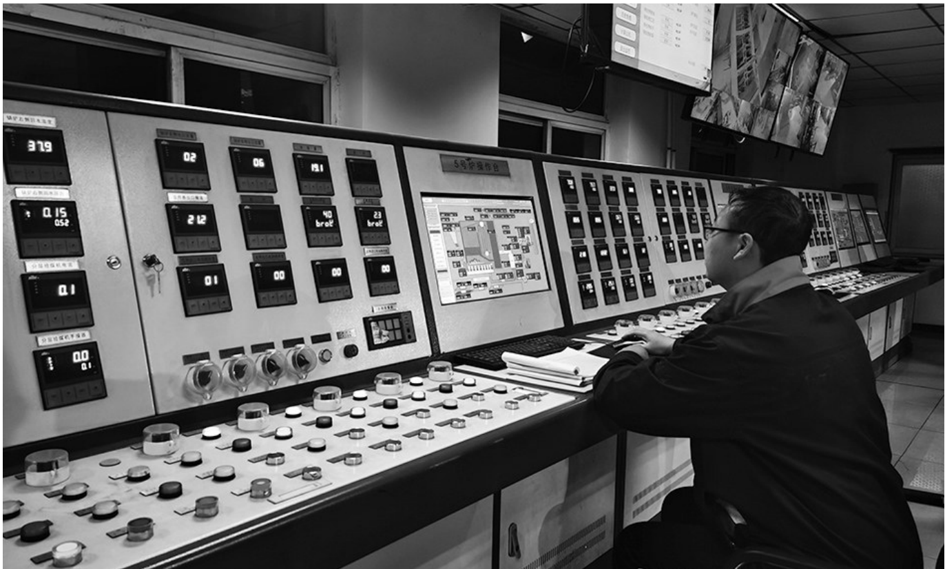
第三热力供暖有限公司热源厂内,工作人员正在监测仪表相关参数。
