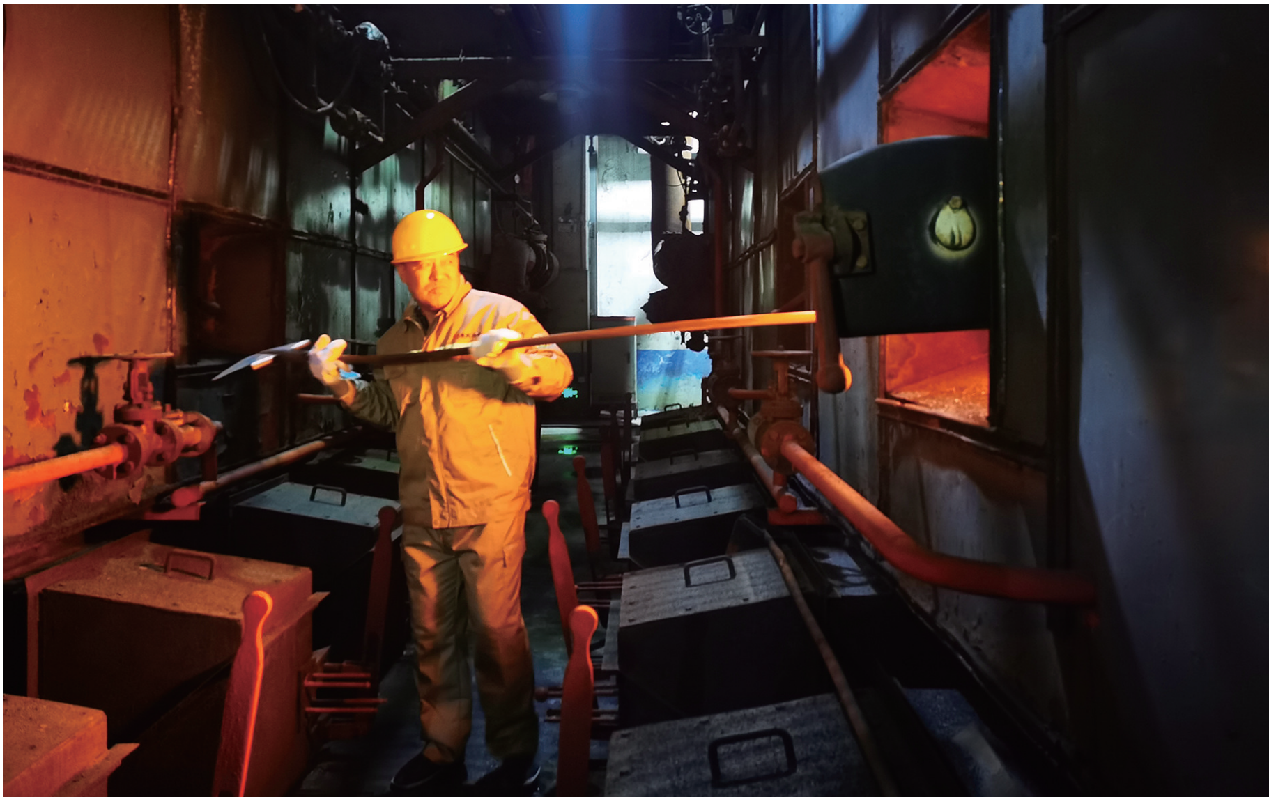
润电铁西二工区滑翔热电厂内,工作人员正在对锅炉进行检查。
