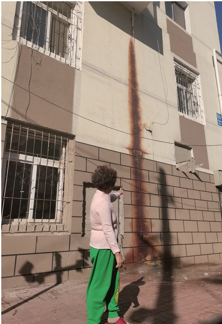
3至8楼的下水管线从三楼阳台引出，直排楼下。
