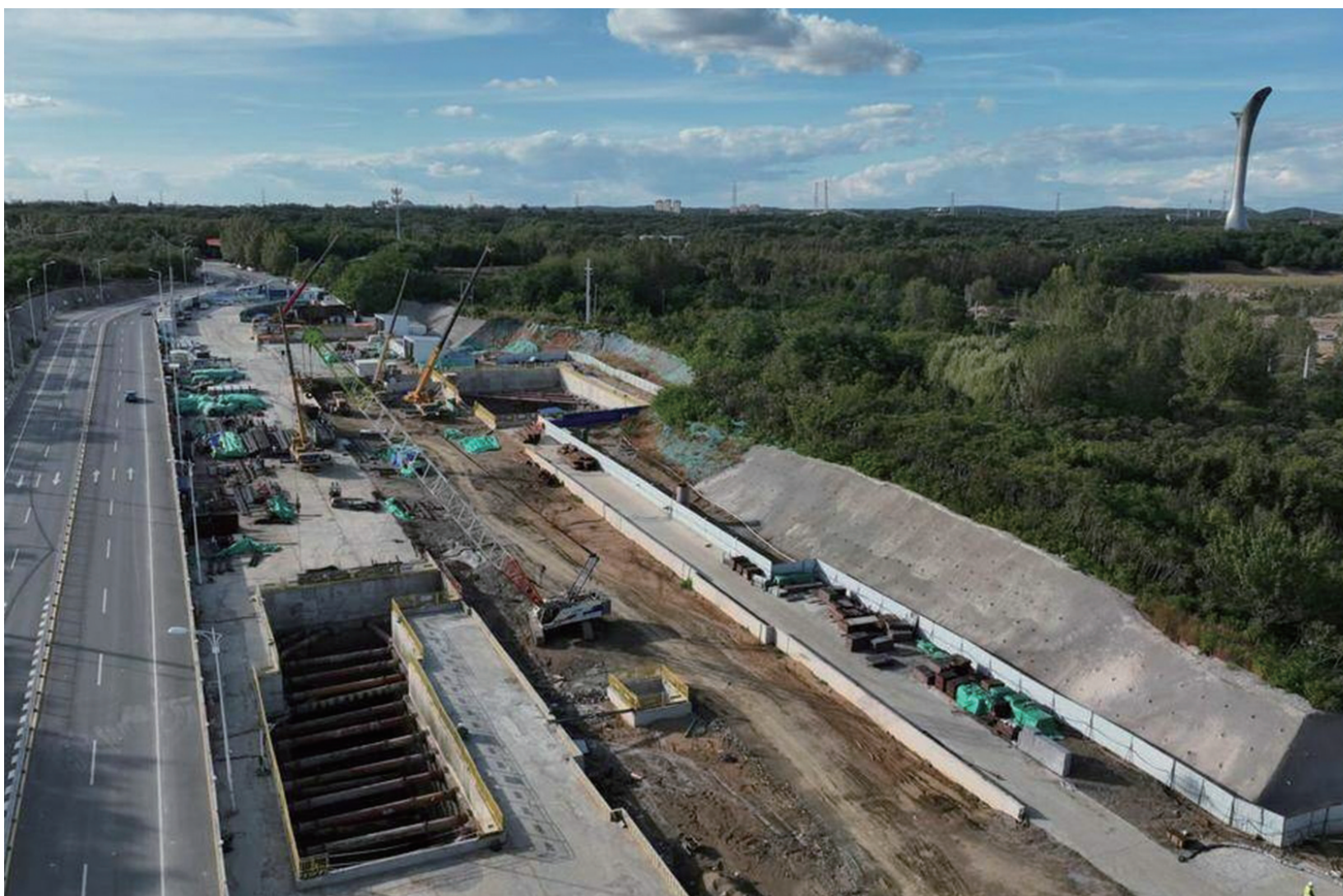
截至目前,沈阳地铁1号线东延线全线10座车站主体结构已经全部完成。
