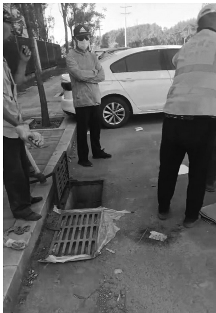
为防止井内臭味散出,工作人员将井口进行临时封闭。 受访者供图
