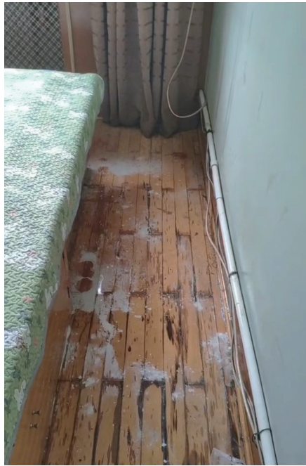
4楼暖气漏水,3楼住户顶棚大白脱落,地板上全是水。受访者供图
