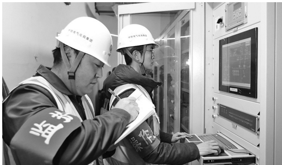
2月23日,在建中的地铁4号线正新路车站内,供电系统工作人员正在操作设备。
