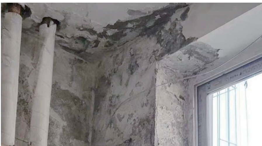
楼道漏雨,墙皮脱落。
